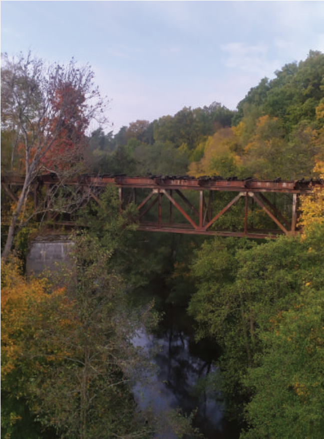
Pozostałości wiaduktu kolejowego w Sportynach fot. Powiat Olsztyński
